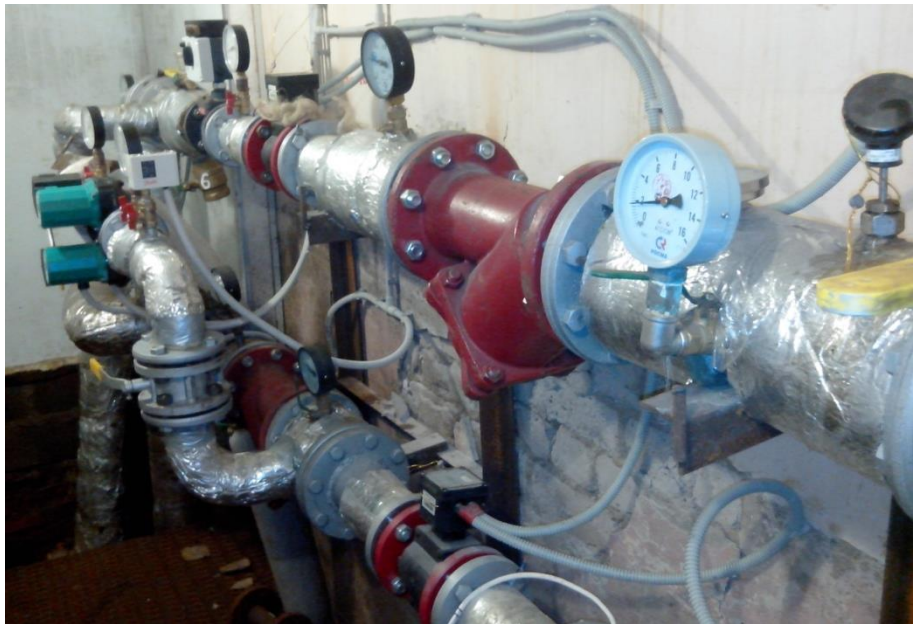
Рисунок 1. Общий вид автоматизированного теплового пункта
